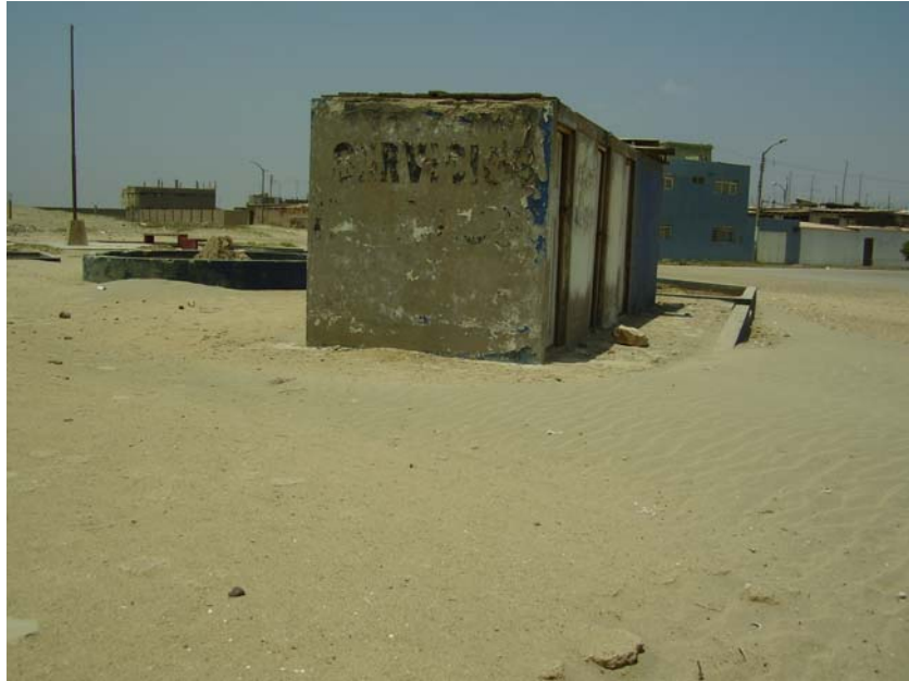
Foto N° 5.- Aquí tenemos un muro el cual a causa del desprendimiento de la pintura ha quedado totalmente descubierto
