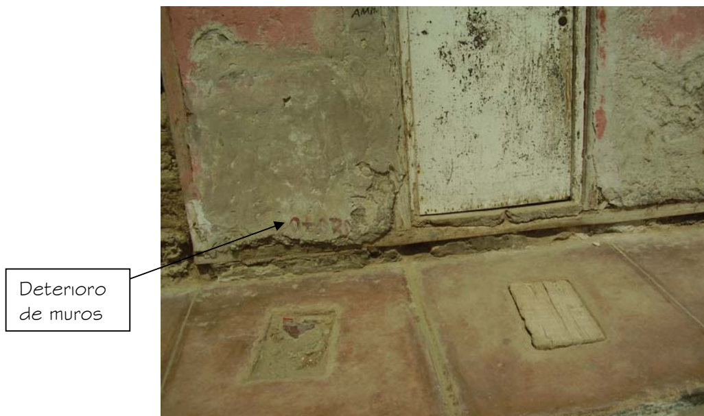
Foto N° 2.- En esta imagen se puede observar claramente el deterioro de los muros de la vivienda.
