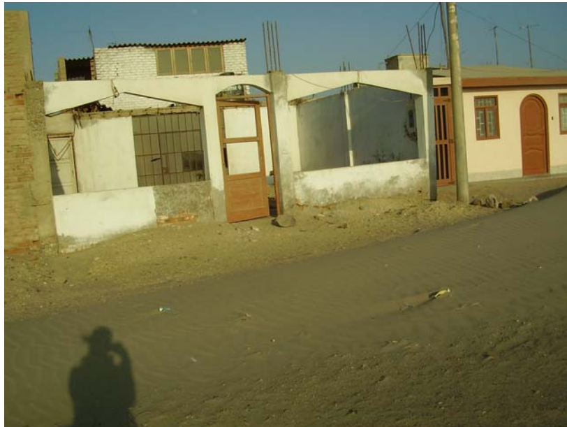
Foto N° 4.- En esta foto observamos como afectan las patologías a las estructuras de las viviendas.
