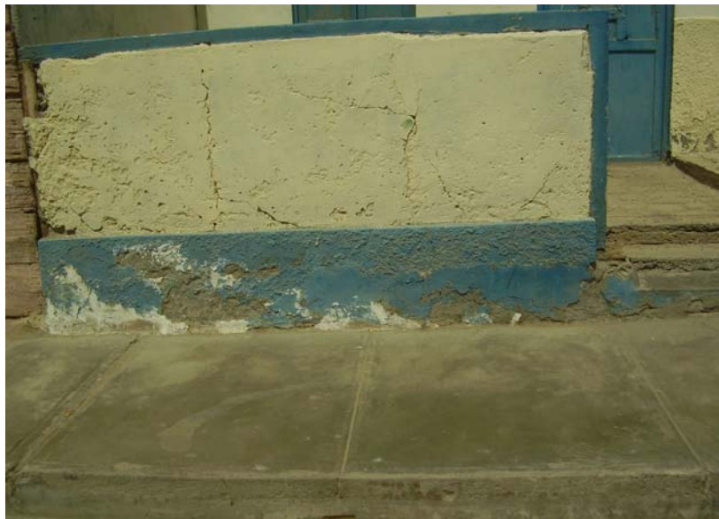
Foto N° 6.-En esta foto observamos todas las patologías estudiadas: desprendimiento de pintura, presencia de salitre, grietas y fisuras, humedad.
