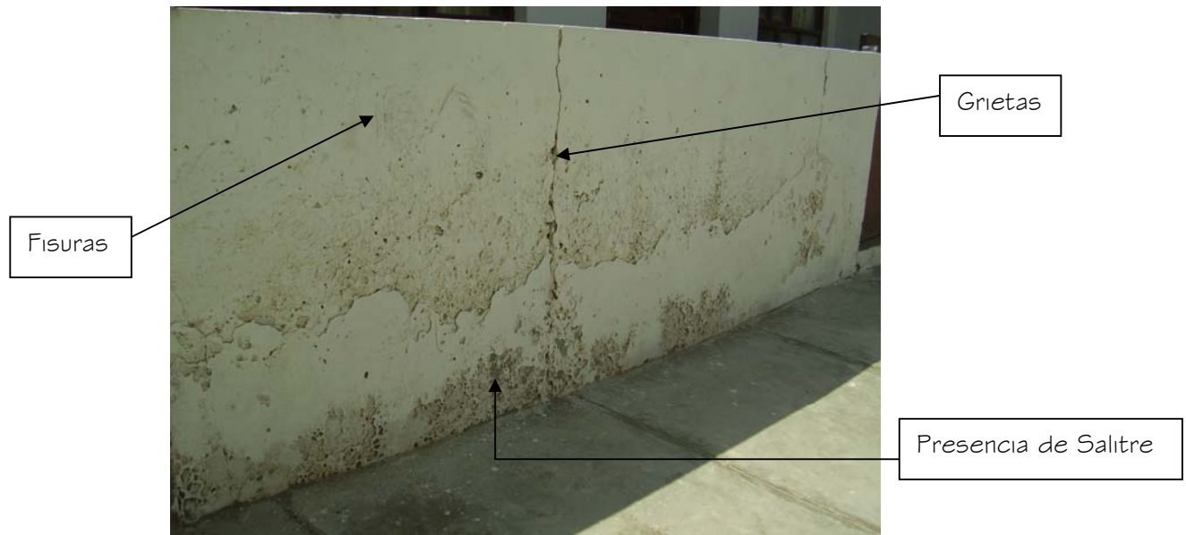
Foto N° 1.- En esta imagen podemos observar las grietas y fisuramientos que ha sufrido el muro de una vivienda, como también la presencia de salitre y humedad.
